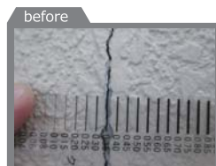
↑外壁にひび割れが見られました。放置すると雨漏れの原因となります。
