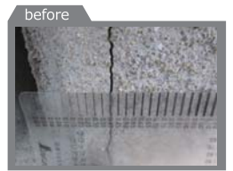
↑ 基礎にひび割れが見られました。この程度のひび割れは安価で補修可能です。
