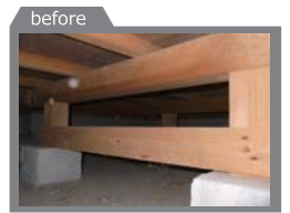
↑ 床下調査の様子。床下は劣化を判断する上で欠かせない調査項目です。この物件は問題ありませんでした。
