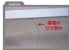
基礎のひび割れ（2ヶ所）はエポキシ樹脂による補修を行いました。
