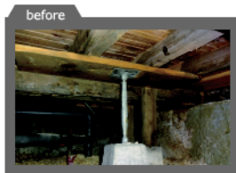
腐朽した土台と対処療法的に設置された束
